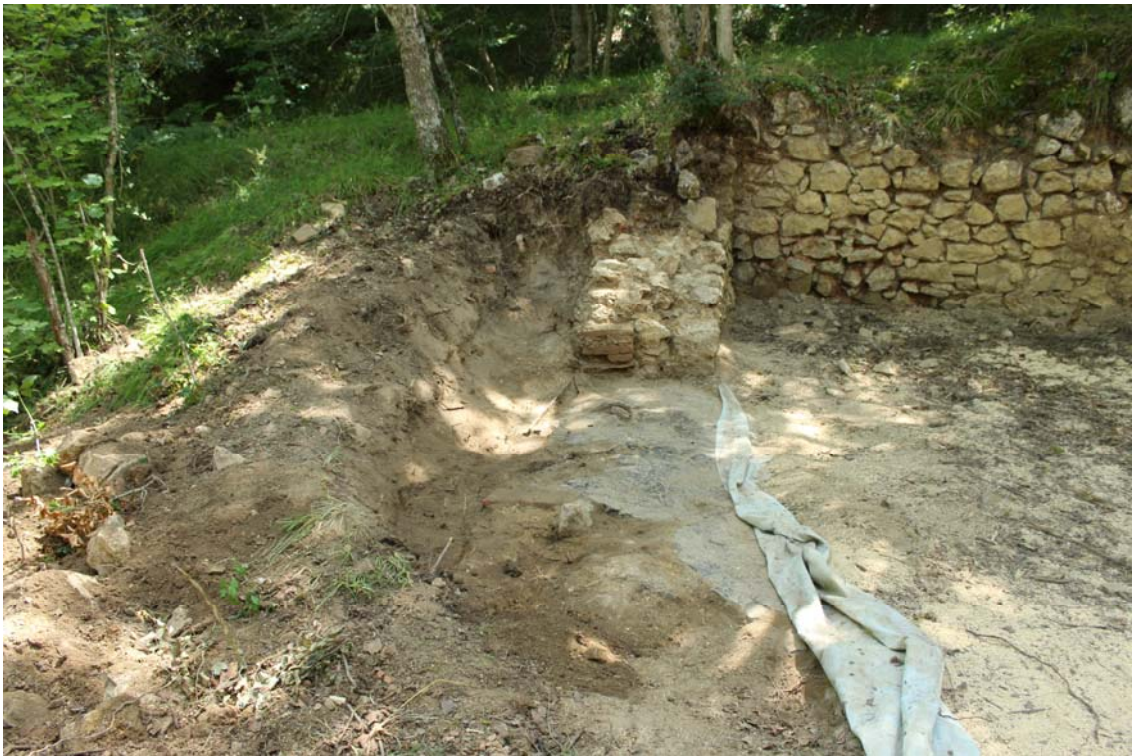
Foto 16. Vista general del muro. Como se ve tuvimos que retirar el geotextil colocado en 2017 y avanzar hacia el E, descubriendo el umbral de la puerta.
