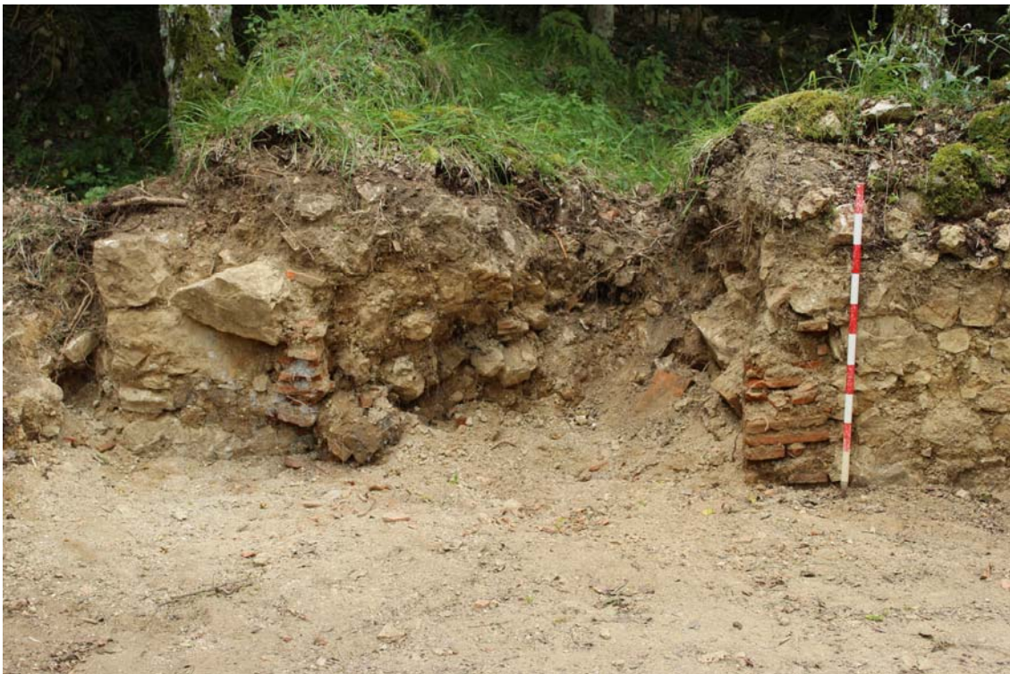
Foto 10. Puerta 1, la más SE. Como se puede ver, no hemos avanzado hacia el interior del edificio, pero hemos dejado a vista el muro y el hueco de la puerta, de 1,56 m de ancho.
